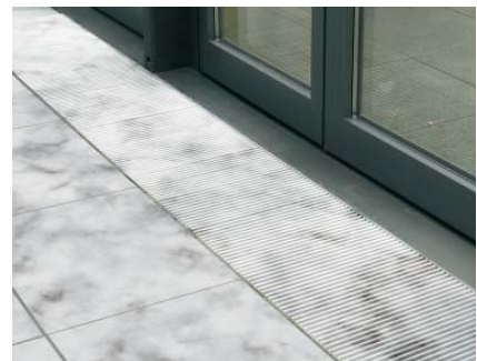
Rost in Dekorton, Oberfläche optisch an Fußboden ausgerichtet
